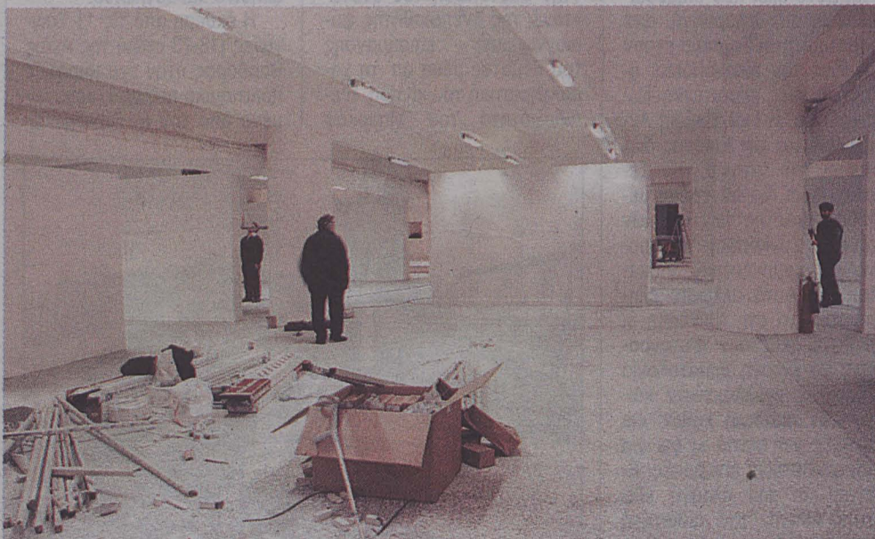
Το Κτίριο Φιξ - ένα μνημείο της μοντέρνας βιομηχανικής αρχιτεκτονικής - ανεγέρθη το 1957 σε σχέδια Τάκη Ζενέτου, κατεδαφίσθηκε εν μέρει και αναπλάθεται τώρα, προκειμένου να εξυπηρετήσει τη στέγαση των αναγκών για ένα μουσείο-κέντρο σύγχρονης τέχνης. Εξωτερικά επενδύθηκε με λινάτσα. Ενώ δίπλα ετοιμάζεται, στον χώρο που κατεδαφίστηκε, εξαώροφο υπόγειο γκαράζ, σταθμός μετεπίδασης του Μετρό, επίγειος σταθμός λεωφορείων και ζώνες πρασίνου
